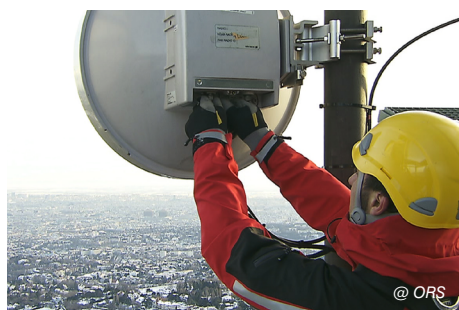
Die ORS sorgt für eine bundesweite UKW-Radioversorgung auf dem neuesten Stand der Technik.
